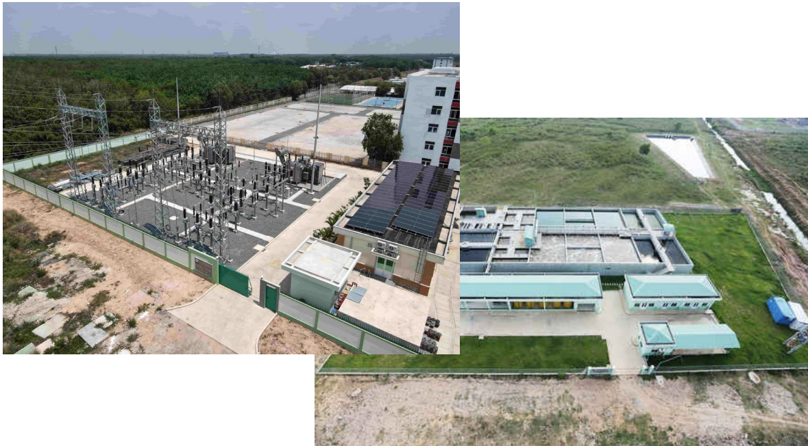
Hình 12: Các trạm biến áp và nhà máy xử lý nước sạch tại KCN Phước Đông
